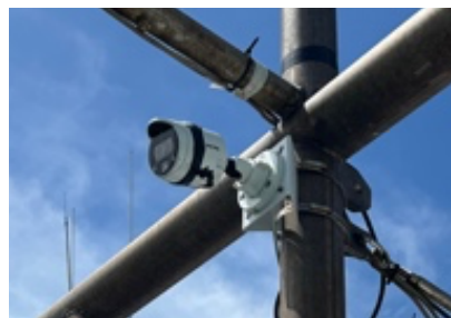
図2 IPカメラの設置
